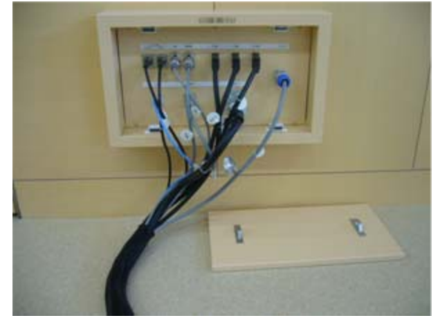
壁面と同じ色合いの接続盤
