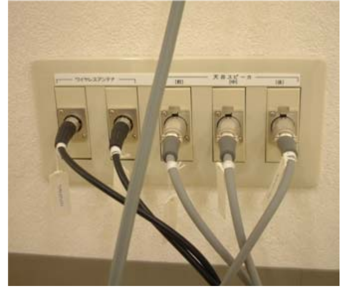
壁面AV設備接続プレート
