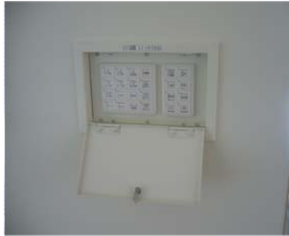
壁面と同じ色合いのスイッチパネルボックス
