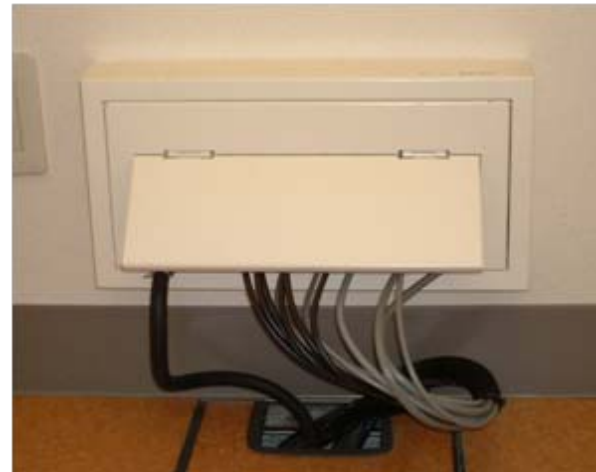
壁面AV設備接続盤 ー外観
