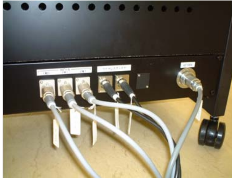
ラック用AV設備接続パネル
