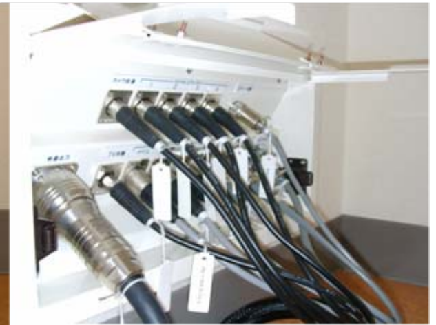
壁面AV設備接続盤 ー接続部
