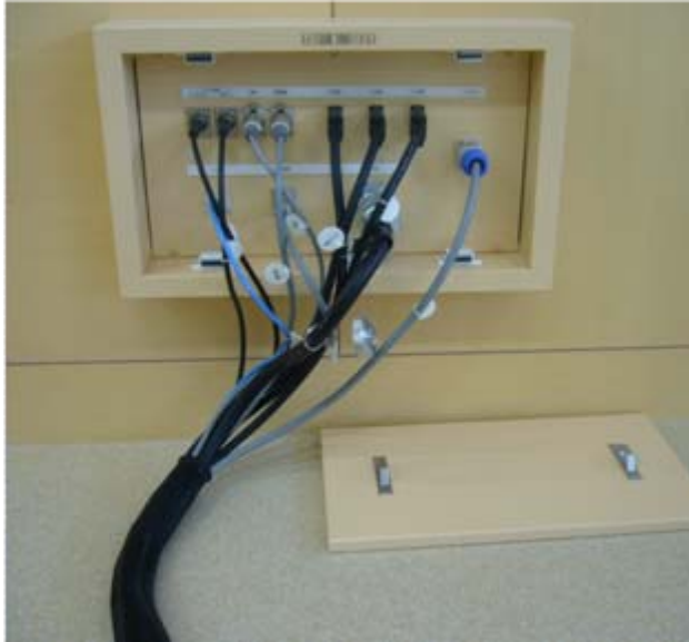
壁面AV設備接続盤
